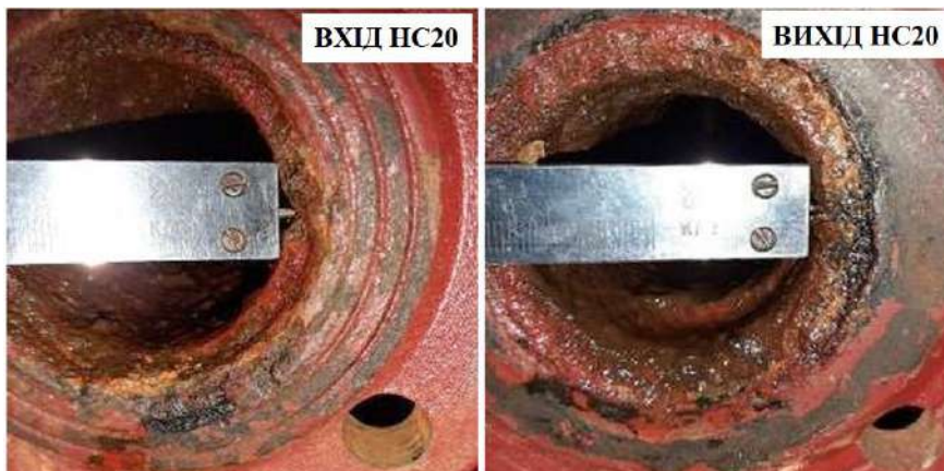
Рисунок 9. Інструментальний замір глибин насічок на відкладеннях на фланцях підведення води в системі водоохолодження електродвигуна НС20 після випробувань (Ліворуч - вхід, праворуч - вихід).
