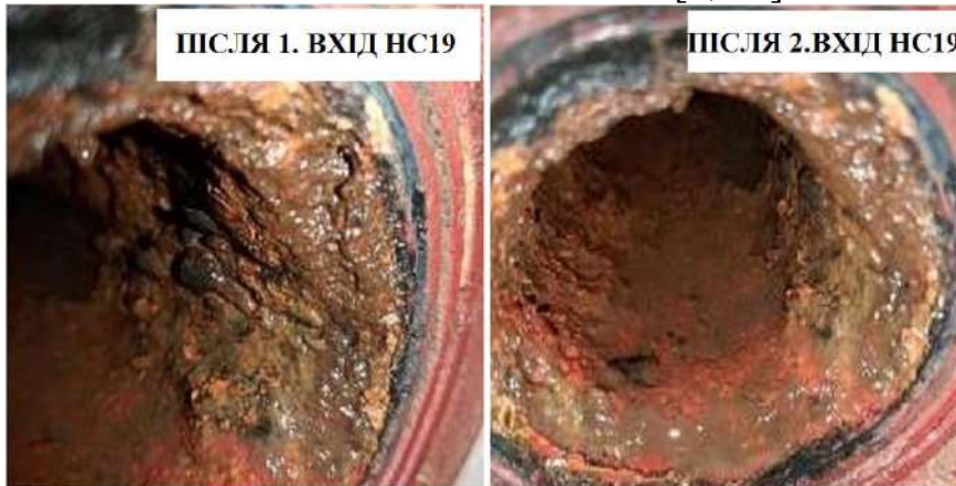
Рисунок 4. Стан насічки на відкладеннях на фланці з боку входу води до системи водоохолодження електродвигуна НС19 після випробувань в двох ракурсах (Ліворуч - ракурс 1, Праворуч - ракурс 2).
