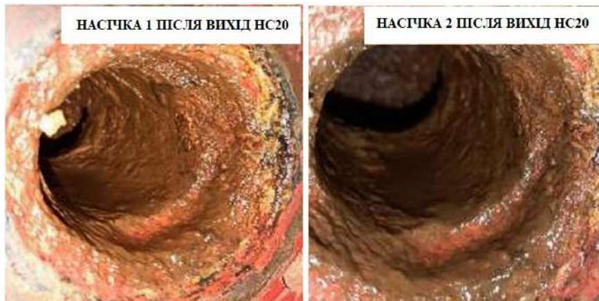
Рисунок 8. Стан насічки на відкладеннях на фланці з боку входу води до системи водоохолодження електродвигуна НС20 після випробувань в двох ракурсах (Ліворуч - ракурс 1, Праворуч - ракурс 2).
