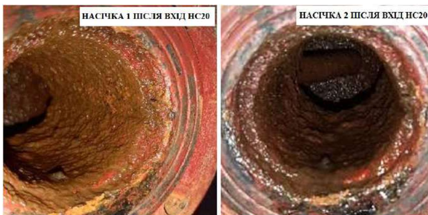
Рисунок 7. Стан насічки на відкладеннях на фланці з боку входу води до системи водоохолодження електродвигуна НС20 після випробувань в двох ракурсах (Ліворуч - ракурс 1, Праворуч - ракурс 2).
